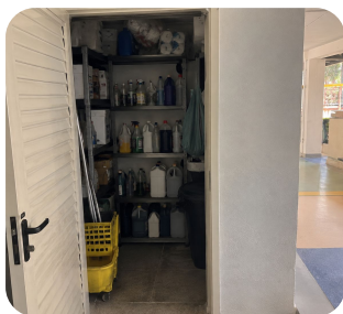
Depósito de produtos de limpeza aberto e ao alcance dos alunos
